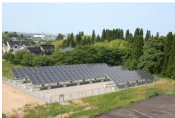
太陽光発電設備
