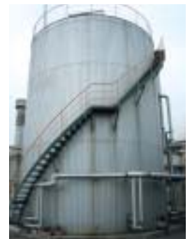
メタン化施設 (バイオリアクター) ※ ※写真は富山グリーンフードリサイクルの施設
